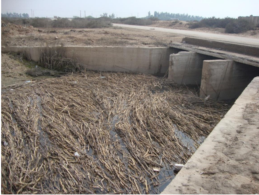
شکل ۱۳- گرفتگی دهانه ورودی یکی از سازه های مسیر سامانه زهکشی
