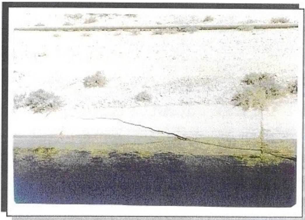
تصویر شماره (۴) - تخریب در قسمتی از کانال D شبکه آبیاری مارون
